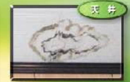
雨漏りによるシミができる。
