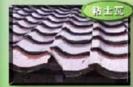
瓦の割れがある。
