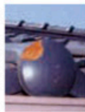
凍害の影響で崩壊が進んだ瓦
